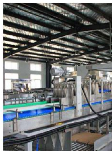
机房车间 测温系统
